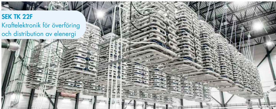
Hitachi Energys spänningsstyva likriktareventilhall.
